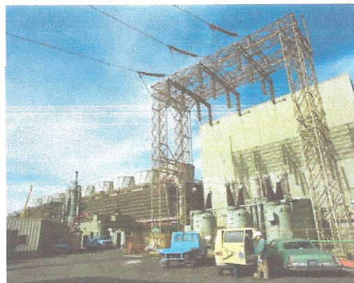
Μονάδα ηλεκτροπαραγωγής περιοχή Geysers, Καλιφόρνια, ΗΠΑ (Πηγή: NREL).
